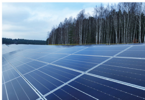
OLSZTYN 1,6 MW - Fotowoltaika
