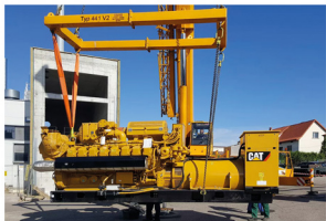
OSM PIĄTNICA 4 MWe - Kogeneracja
