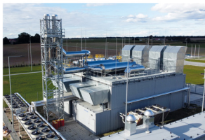
ORLEN UPSTREAM 17,6 MWe - Kogeneracja
